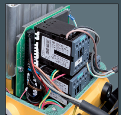
COMMANDE BASSE TENSION
